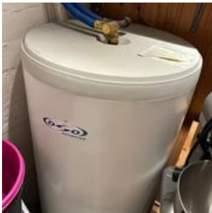
Varmtvannsbereder plassert i bod under trapp.
