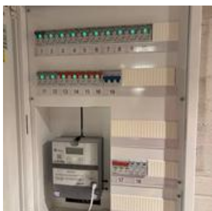
Sikringsskap med automatsikringer plassert i bod.
