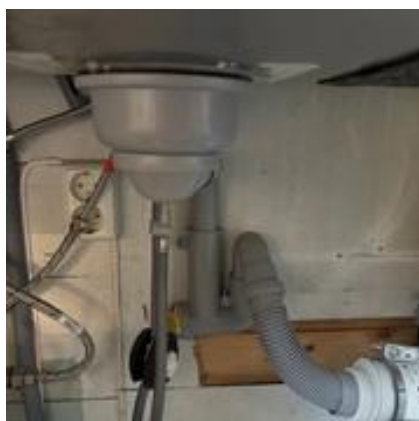
Avløpsrør i underskap vask på kjøkkenet.
