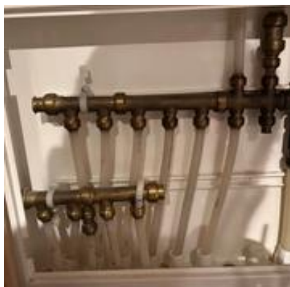
Rørfordelerskap plassert i bod, mot vegg til bad/vaskerom.
