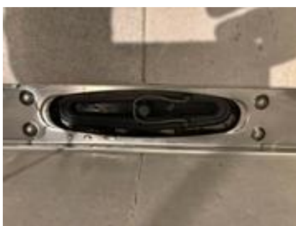
Baderomssluk plassert i dusjsone.
