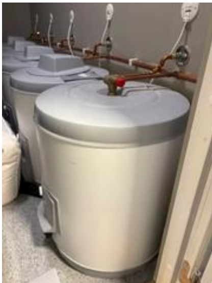
Varmtvannsbereder plassert i felles "berederrom" i gangen.
