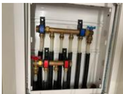
Rørfordelerskap med stoppekran for varmt og kaldtvann, plassert i vaskesone på bad/vaskerom.
