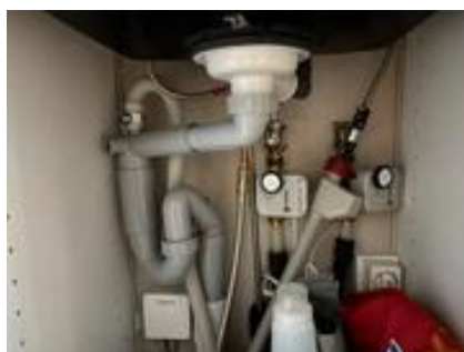
Avløpsrør i underskap vask på kjøkkenet.
