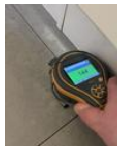
Fuktsøk på gulv ved installasjoner for vann.
