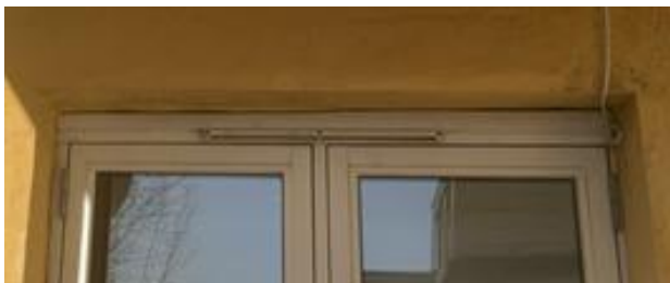
Ventilasjon av leiligheten skjer kun via spalte i vinduskarmer.
