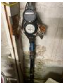
Hovedstoppekran i kjeller med felles vannmåler.
