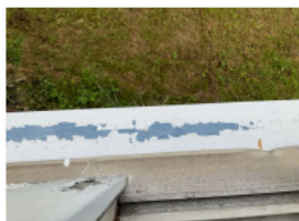
Avflasset beslag på gavlvindu.
