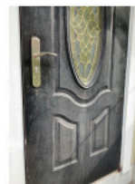
Dør 2. etg. Rust og overflateskader.
