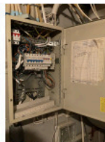
Sikringskap i kjelleren. Berøringsfare (mulighet for støt).
