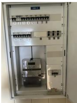
Sikringskap med automatsikringer i leiligheten.
