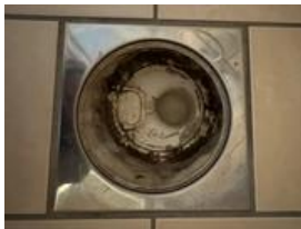
Badromssluk plassert i dusjsone.
