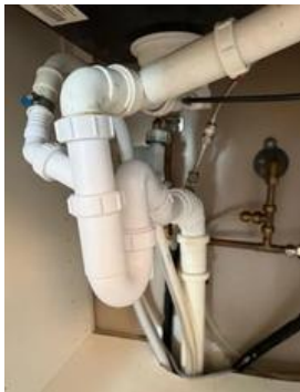
Avløpsrør i underskap vask på kjøkkenet.
