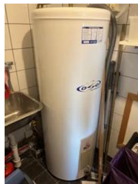
Varmtvannsbereider til boligen er plassert i vaskerom.
