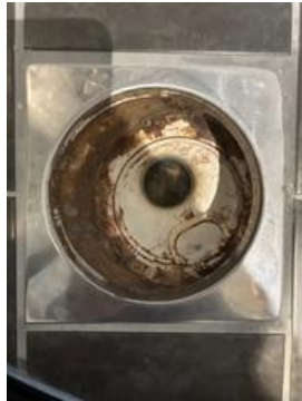
Baderomssluk plassert i dusjsone.
