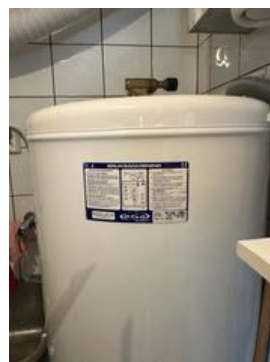
Varmtvannsbereider til leiligheten plassert i bad/vaskerom.
