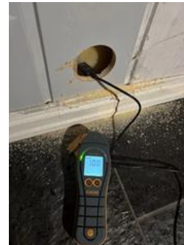
Hulltaking for rom under terreng, tatt under trapp ved gangen til boligen. Målingen viser normale fuktverdier.
