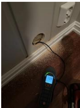
Hulltaking med fuktmåling mot våtsone uten avvik målt fra tiliggende disponibelt rom.
