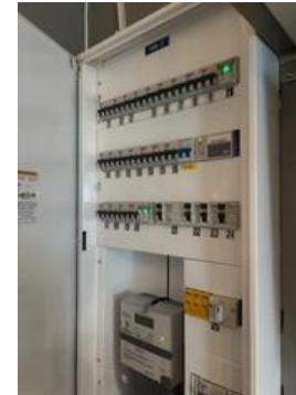
Sikringskap med automatsikringer i boligen plassert i treningsrom.
