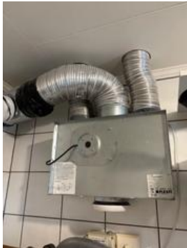
Flere Flexit avtrekk montert i boligen til ventilering av våtrommene.
