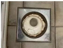
Baderomssluk plassert i dusjsone.
