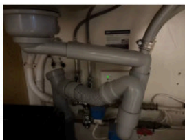
Avløpsrør i underskap vask på kjøkkenet.
