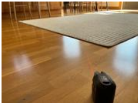
Nivellering spise kjøkken, avvik ca. 10-20 mm
