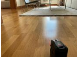
Nivellering stue, avvik ca. 10-20 mm
