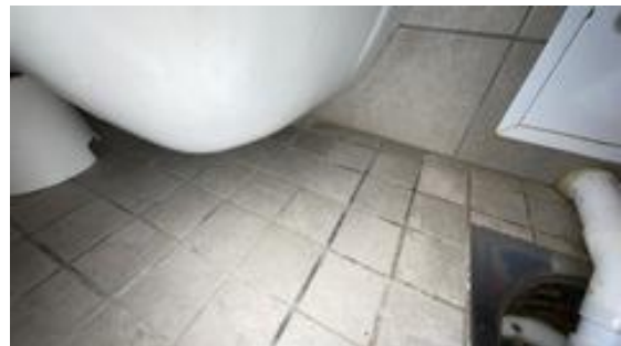
Lekkasjespalte på innebygget sisterner bør opparbeides.
