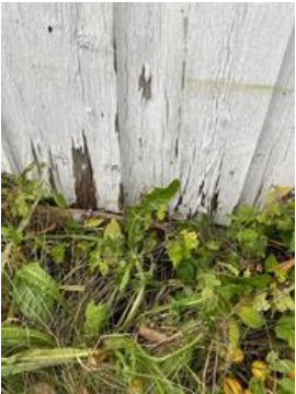
Det er råte i paneler på veranda med takoverbygg.
