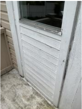
Balkongdør i 2. etasje er slitt.
