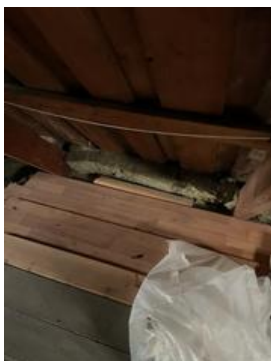
Ventilering av skråtak er fraværende, det kan ikke utelukkes skader i takverk på grunn av utførelsen.
