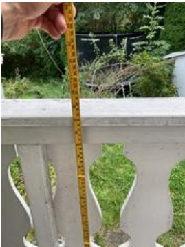
Rekkverk er lavt.
