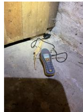
Det er målt betydelig fukt i treverk.
