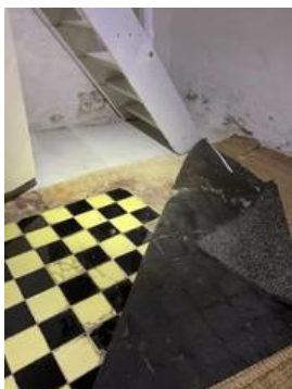
Betonggulv trekker opp tilgjengelig fukt, dette er synlig hvor teppe har ligget.
