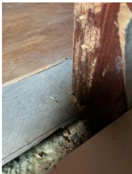
Hull etter skadedyr på gulvplank.
