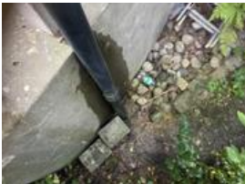
Det ligger vann i terrenget mot sør.
