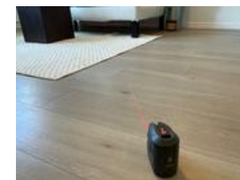
nivellering stue/kjøkken, avvik ca. 15-30 mm
