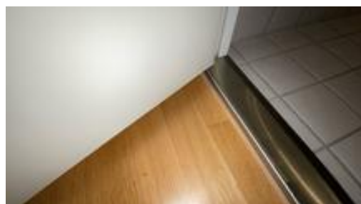
Luftespalte under dørrbladet.
