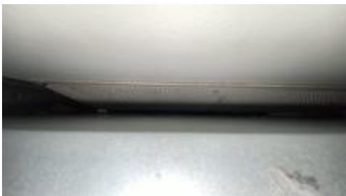
Luftespalte under vinduer (bak panelovn).
