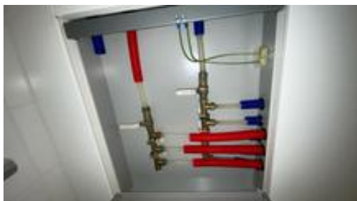
Fordelerskap på badet.
