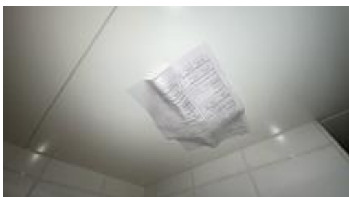
Test med løst ark viste tilfredstillende avtrekk.
