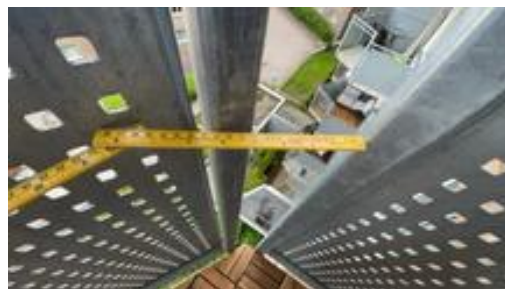
Åpning i rekkverk.
