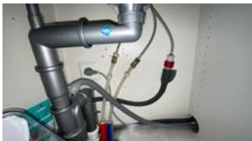
Rørpropplegg på kjøkken.
