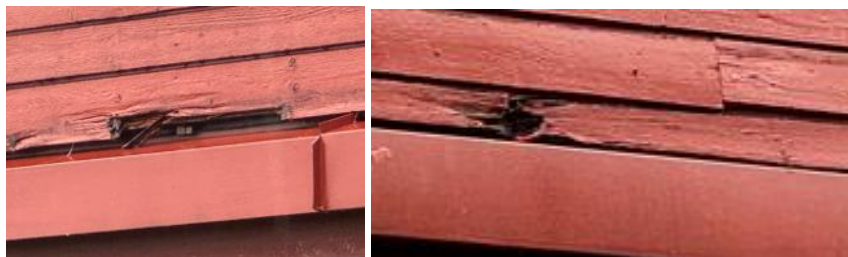
Eksempel på råteskader
