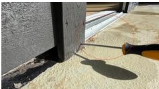
Bilde viser manglende avstand mellom dørlist og terrassedekket, dørterskel.
