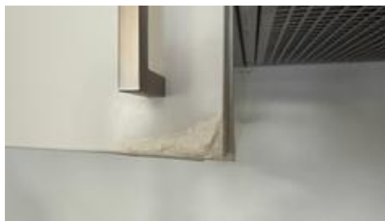
Bilde viser eksempel på skade. Her på dørfront.
