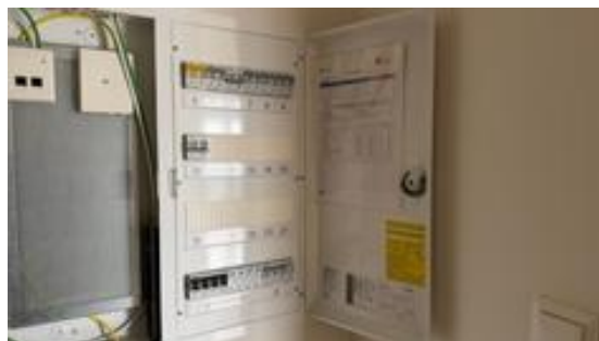
Bildet viser sikringsskap for det elektriske anlegget.
