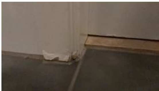
Fuktskade på gerikt.
