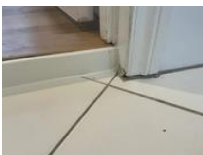
Sprekk i fuger ved dør.
