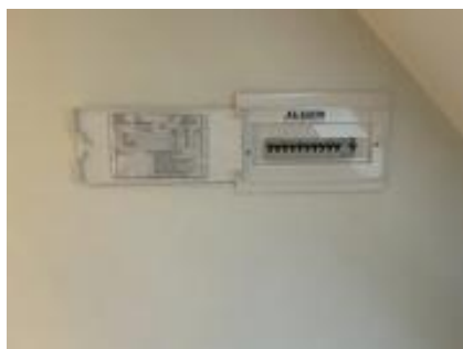
Sikringsskap på loft.
