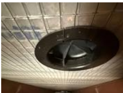
Ventil i undertak.
