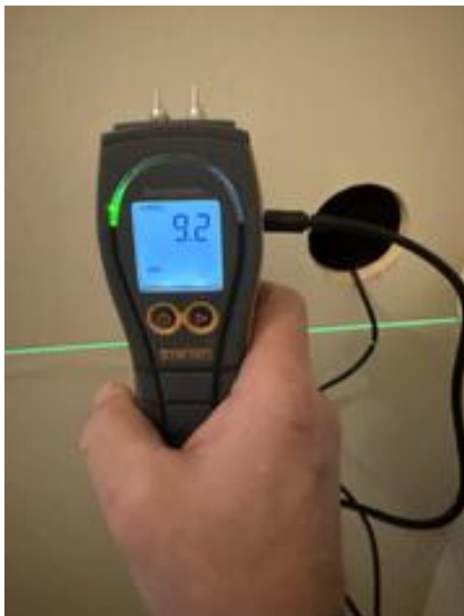
Det ble ikke målt unormal fukt i vegg mot våtsone.
