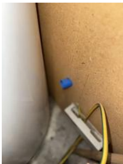
Drenering for synliggjøring av lekkasjevann.
