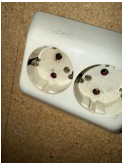
Antydning til svimerke i stikkontakt.
