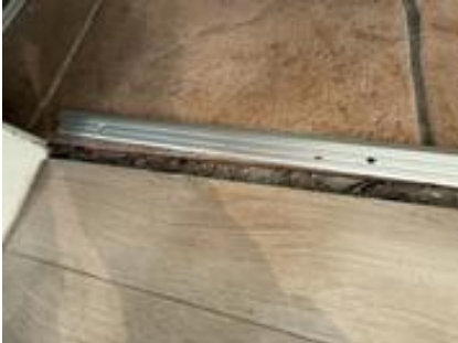
Flis er løs og overgangslist er ikke festet.
