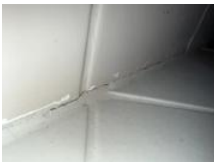
Sprekker i fuge.
