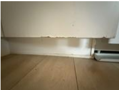
Skitasje på skapdør ved servant.
