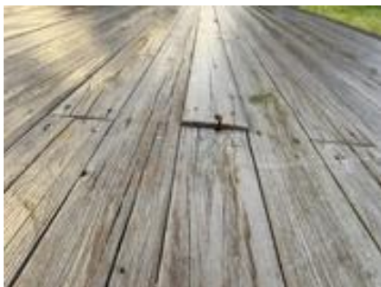
Gulvet har behov for vedlikehold.
