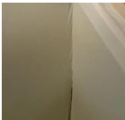
Luftlomme bak tapet of sprekk i hjørnet i trappeoppgang.
