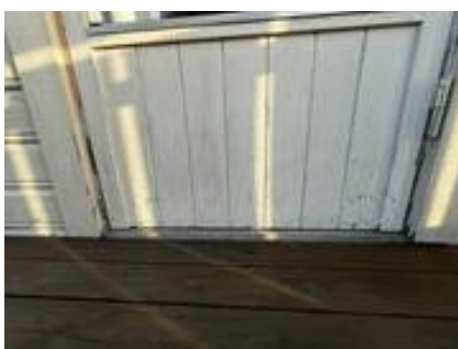
Slitasje på dør til balkong i 2. etasje.
