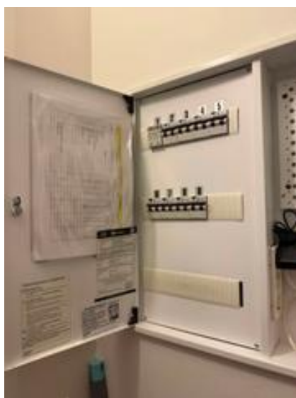
Sikringsskap er plassert i bod.
