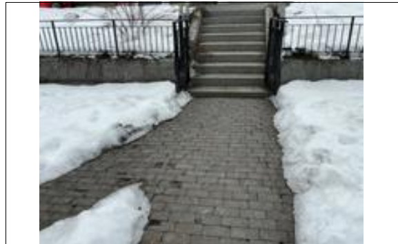
Gjerde og port i alu, noe avflassing av emalje.
