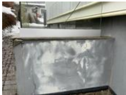
Avflassing av maling, skadet skifer, avstand mellom rekkverket og huskropp er mere en 10 cm. bom/hullyd under skifer
