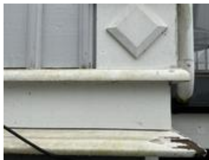
Avflassing av maling
