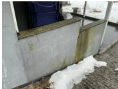
Avflassing av maling, bom/hullyd under skifer
