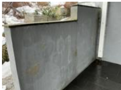
Riss i mur/betong
