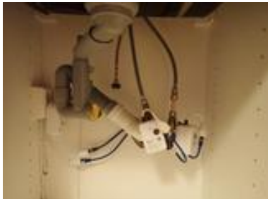
Avløp i kjøkkenbenken
