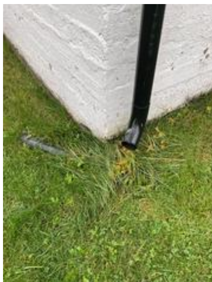
Takvann er ledet vekk fra mur.
