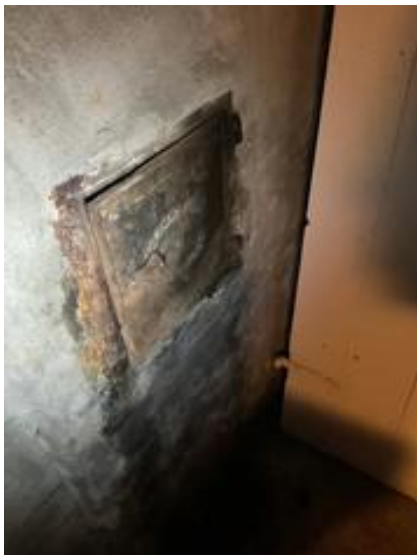
Sotluke er defekt.
