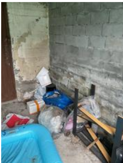
På innside mur er det symptomer på fuktgjennomtrenging.
