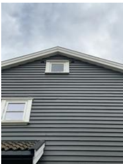
Lufteventiler i gavler.
