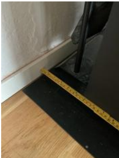
Listverk er for nærme ildsted.
