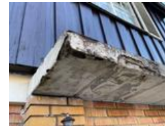
Avskallinger i utkraget etasjeskiller.
