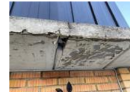
Avskallinger i utkraget etasjeskiller.
