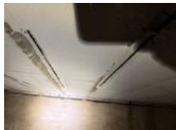
Delaminering i etasjeskilleren. Eksempel.
