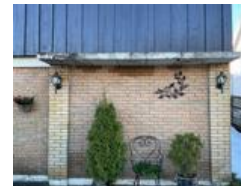
Avskallinger i utkraget etasjeskiller.
