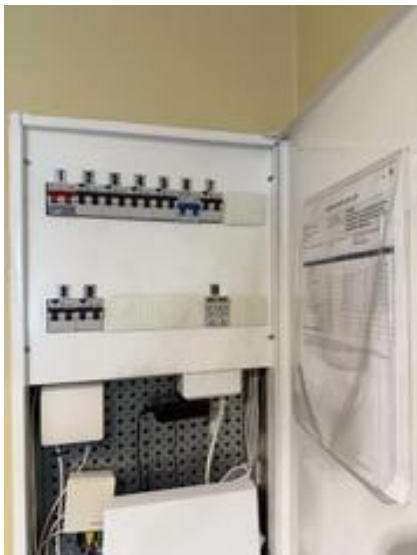
Sikringsskap er plassert i entre/gang.
