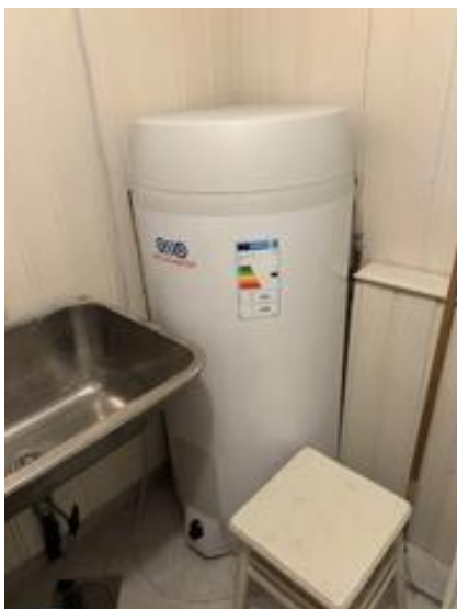
Varmtvannsbereder plassert i bad/vaskerom.
