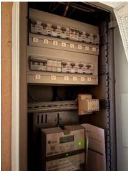
Sikringsskap med automatsikringer plassert i bod under trapp.
