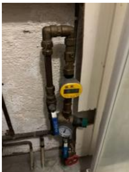
Vannmåler og stoppekran lett tilgjengelige plassert på bad/vaskerom.
