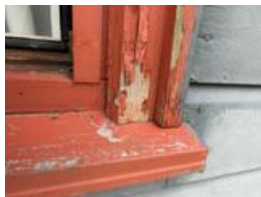
Eksempel på værslitt overflatebehandling.
