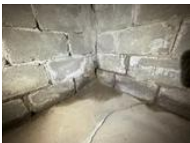
Eksempel på fukt i vegg/gulv.
