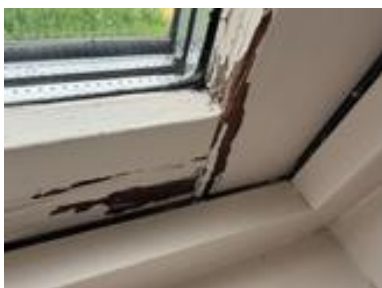
Eksempel på innvendig fuktmerker.
