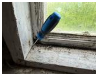
Eksempel på vindu med råteskade i kjeller.
