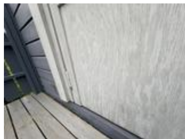
Eksempel på værslitt overflatebehandling.
