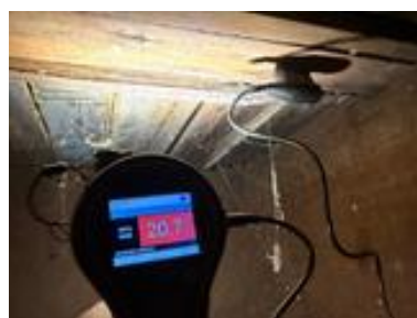
Eksempel på forhøyet fuktmåling mot bjelkelaget fra kjeller.
