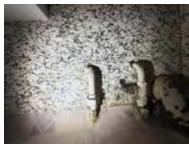
Eksempel på utett rørgjennomføring i vegg.
