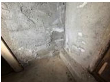
Eksempel på saltutslag på vegger.
