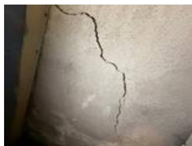
Eksempel på sprekk i grunnmur.
