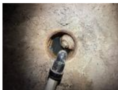
Eldre jernsluk i gulvet.
