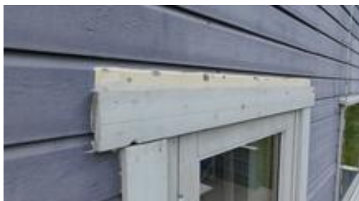
Det er ikke vannbrettbeslag over balkongdøren.
