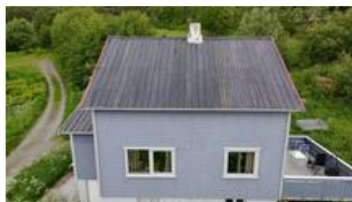
Det er ikke etablert takrenner /nedløp.
