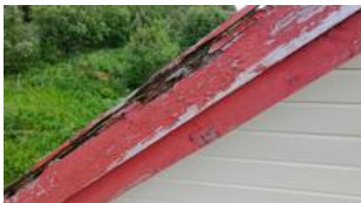
Eksempel på råteskader.
