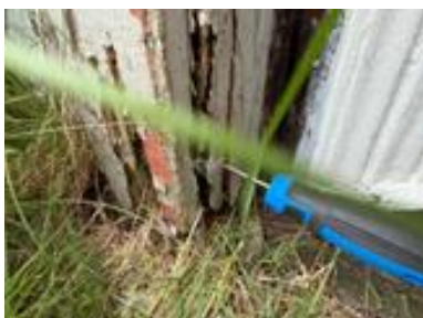
Eksempel på råteskade i karm.
