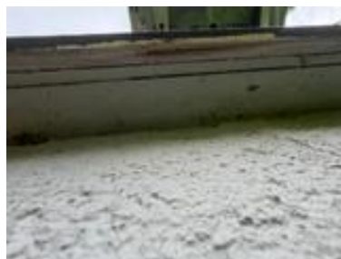
Det er ikke etablert lufting bak kledningen.
