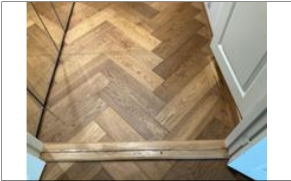
Knirk/ svik i gulv ved dør til entre.
