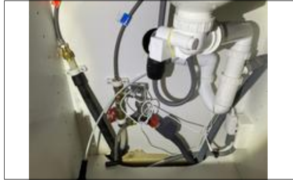
Rørapplegg i kjøkkenbenk
