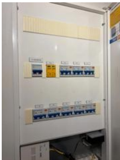
Sikringskapp med automatsikringer plassert i walk-in closet.
