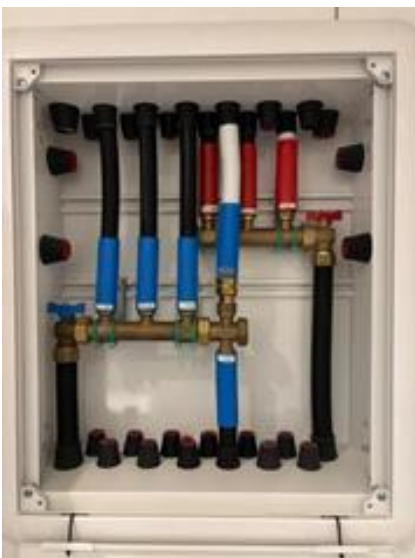
Rørfordelerskap plassert i vegg på bad/vaskerom.
