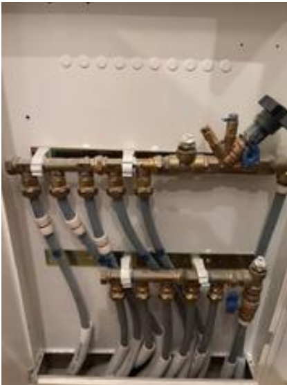
Rørfordelerskap for vannbåren varme (radiatorer) er plassert i vegg på walk-in closet.
