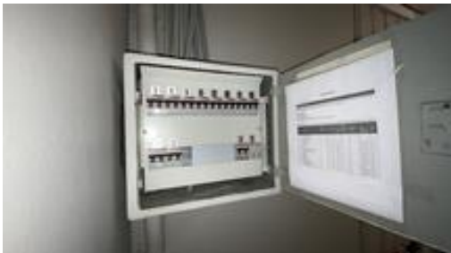
El.skap i fellesgang.
