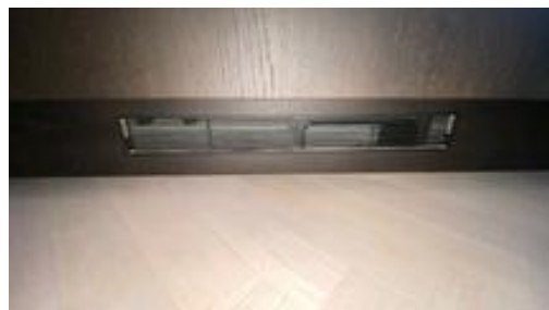
Utkast for avtrekksluften i sokkelen på kjøkkenet.
