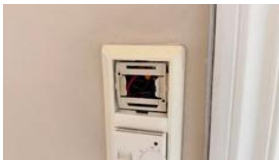
Bilde viser manglende deksel (bad 2. Etasje).
