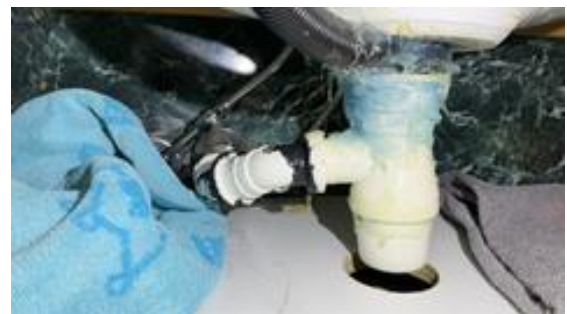
Bilde viser nevnte avvik på bad i 2. Etasje.
