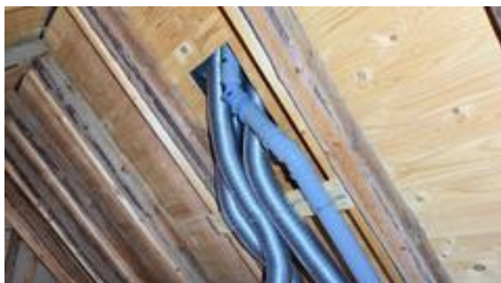
Luftekanaler på loft som mangler isolasjon (risiko for kondens).
