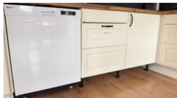
Bilde viser nevnte slitasje på kjøkkenfronter og manglende sokkel-list på deler av kjøkkenet.
