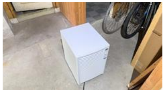
Bilde viser at det er montert en avfukter i underetasjen.
