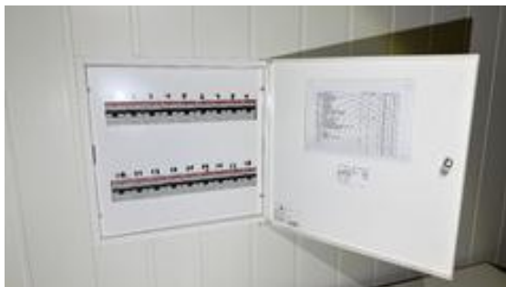
Bilde viser et av to sikringskap i boligen. (1. Etasje)
