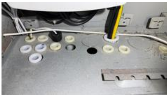
Bilde viser at det er utettheter i sikringskap i 2. Etasje.
