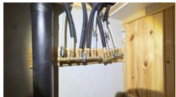
Bilde viser deler av rørfordelingen i underetasje.
