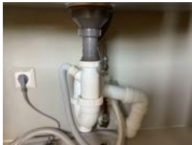
Avløpsrør i underskap vask på kjøkkenet.
