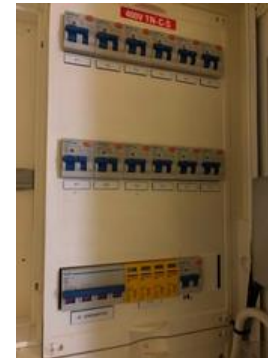
Sikringskap med automatsikringer plassert i skap på teknisk rom/bod.
