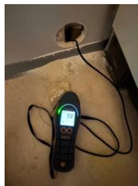
Hulltaking med fuktmåling mot våtsone uten avvik målt fra tilliggende teknisk rom/bod.
