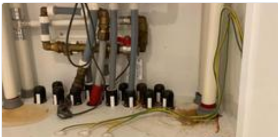
Rustdannelser i skapet og drypping fra koblingspunktet over rustdannelser.
