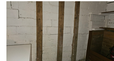
Jord press skade på grunnmur
