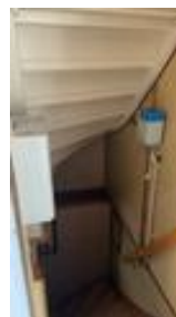
Dagtank og tilbakeslagsventil plassert i trappe til kjeller.
