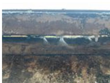
Utettheter mellom vindu og karm
