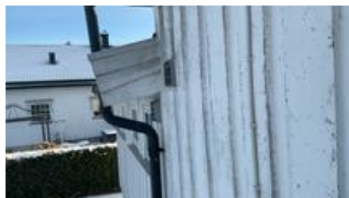
mekanisk avtrekk ut på yttervegg.
