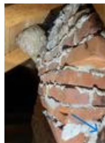
Pipe på loft, har merker av sotvann utvendig.
