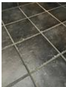
Noe småskader i flisoverflaten ved servant
