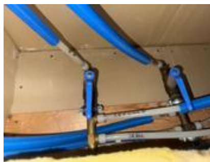
Stoppekraner over luke i himling på badet.
