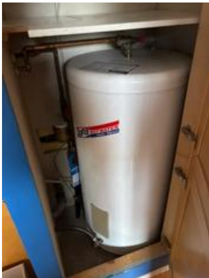
Varmtvannsbereder plassert i kott på kjøkkenet.
