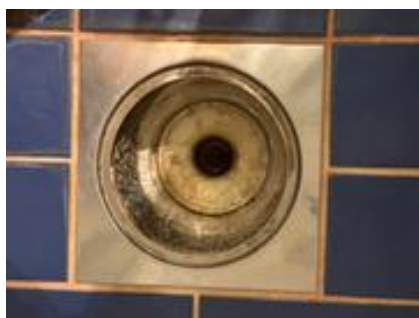
Baderomssluk plassert i dusjsone.
