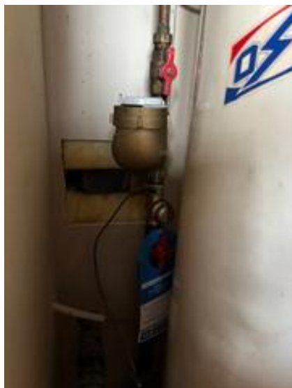
Hovedstoppekran synlig plassert og lett tilgjengelig i kott på kjøkkenet.
