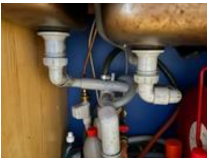
Avløpsrør i underskap vask på kjøkkenet.
