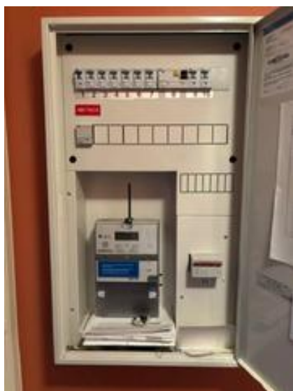
Sikringsskap med automatsikringer plassert i entre.
