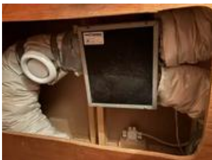
Avtrekksvifte plassert i loftsod fungerer ikke optimalt og bør skiftes.
