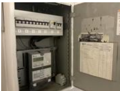
Sikringsskap plassert i felles trappegang.
