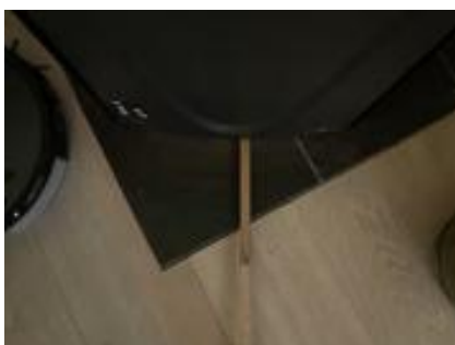
Ikke tilfredsstillende avstand til brennbart materiale.
