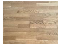
Parkettgulv i stue/kjøkken har en mindre svelleskade
