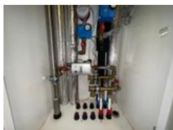
Fordelerskap vannbåren varme
