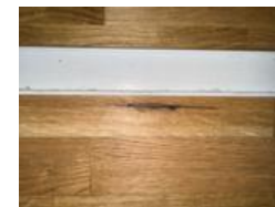
Sår på parkettgulv i entré
