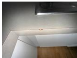
Påvist synlig skade/sår på dekside ved oppvaskmaskin.
