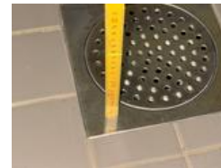
Fallforhold ca. 145 mm topp slukrist i dusjsone
