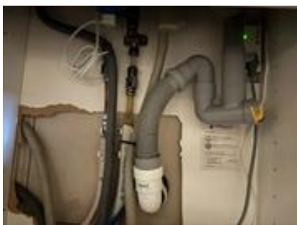
Avløpsrør i underskap vask på kjøkkenet.
