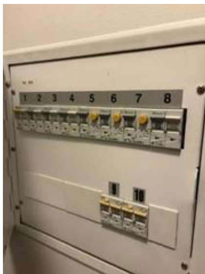
Sikringsskap med automatsikringer plassert i bod.
