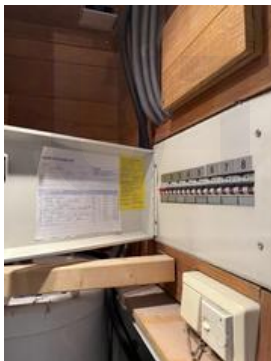
Sikringskap er plassert i skap i entre. Kursfortegnelse på innside skapdør.
