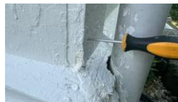
Bilde viser et hjørnebord med råteskader.
