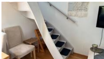
Bilde viser trapp med manglende rekkverk.
