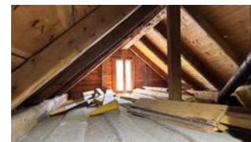
Bilde viser deler av kaldtloft, hvor det stedvis er skiftet ut sutak.
