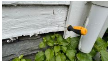
Bilde viser nedre kledningsbord med rāteskade.
