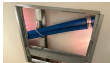
Vannrør bak luke i tak bad. Muligens tilførsel vann kjøkken.
