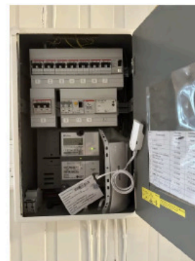
Sikringskap med automatsikringer i gang. Kursfortegnelse på innside av skapder.
