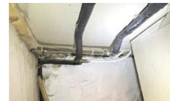
Kobbervannrør i kjeller bør isoleres.
