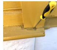
Råte i vannse under kledning
