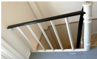
Lavt rekkverk med for store åpringer mellom spilene.
