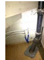
Kobberrør og rør i rør i kott under trapp
