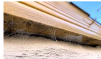
Lite og ingen lufting bak kledning
