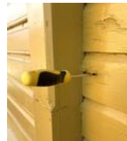
Råte i enkelte kledningsbord
