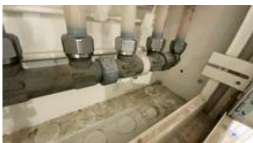
Avrenningshull inni fordelerskapet.
