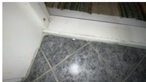
Ingen membranløsning kan konstateres visuelt ved dørterskel.
