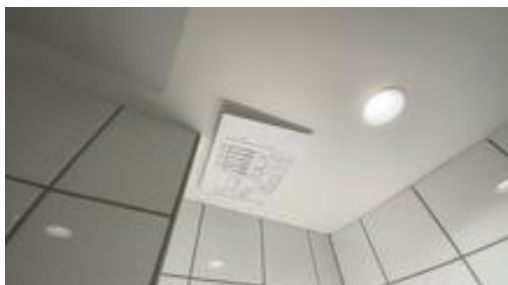
Test med løst ark viste tilfredsstillende avtrekk.
