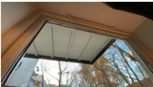
Luftespalte over vindu.
