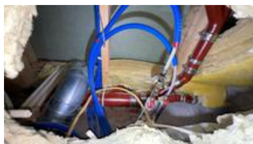
Rørplegg over himling på baderommet.
