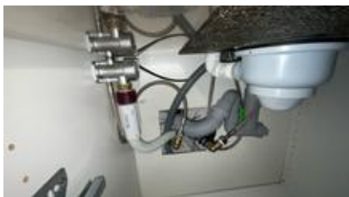
Rør på kjøkken.
