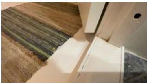
Luftespalte under dørbildet.
