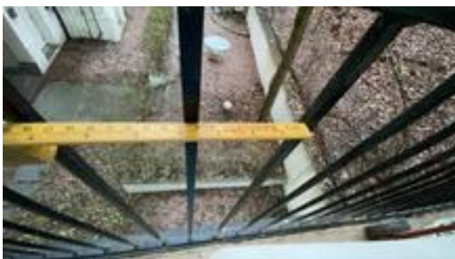
Åpninger i rekkverk.
