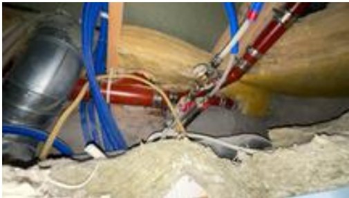
Avløpsrør i rød farge.
