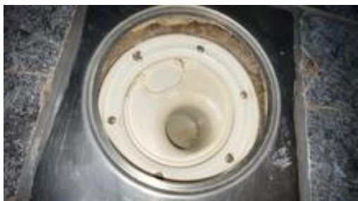
Sluk. Synlig dukmansjett under klemring.
