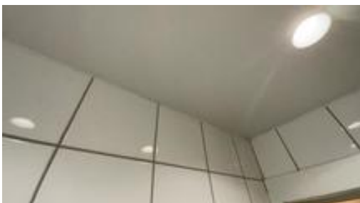
Noen glipper i silikonefuger i overgangen mellom vegg og himling.
