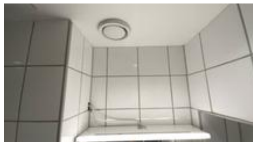
Ungøyaktig utførelse av gjennomføring av ledning.
