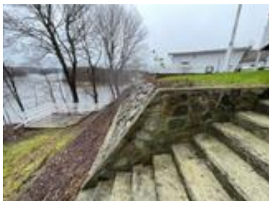
Støttemur som mangler rekkverk.
