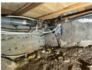
Vann og avløpsrør i krypkjeller.
