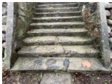
Sprekk i betongtrapp.
