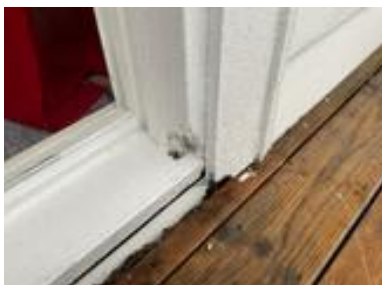
Råte nederst på karm
