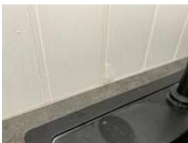
Svelling på veggplater ved oppvaskkum
