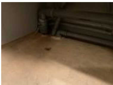
Avrenning fra dusjkabinett
