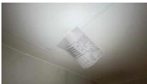
Test med løst ark viste tilfredsstillende avtrekk.
