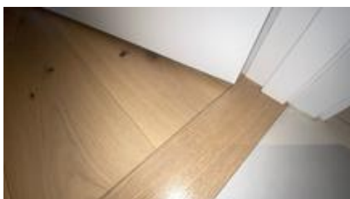
Luftespalte under dørbildet.
