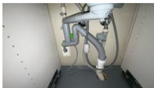
Røropplegg på kjøkken.
