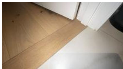
Overgang ved dørterskel. Ikke mulig å konstatere type membranløsning her.
