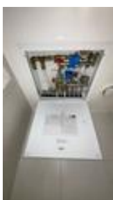
Fordelerskap. Røranvisning på innsiden av fordelerskapet.
