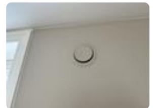
Tilluftsventil i vegg
