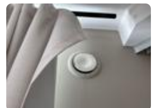
Tilluftsventil i vegg
