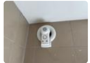
Mekanisk avtrekk i vegg
