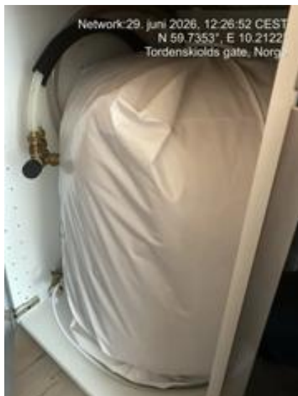
Bereder i kjøkkenskap
