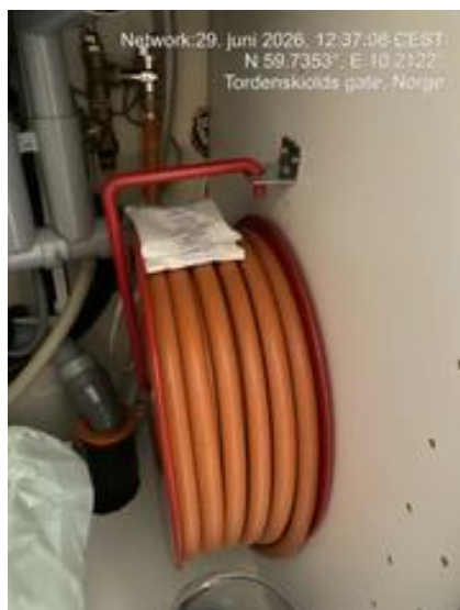
Brannslange i vaskeskap
