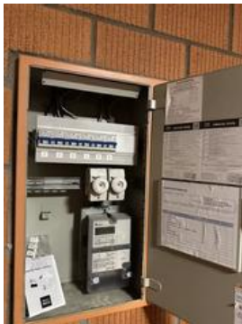
Sikringskap er plassert i felles area. Kursfortegnelse på innside skapder.
