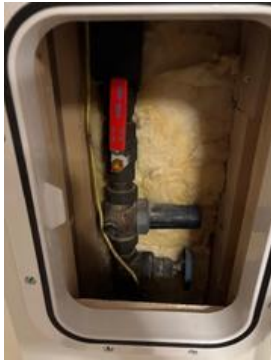
Hovedstoppekran for hele boligen og resten av rekkehusene i rekke er plassert bak inspeksjonssluke i vegg i kjellerstuen.
