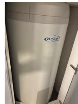
Varmtvannsbereider plassert i skap på vaskerom.
