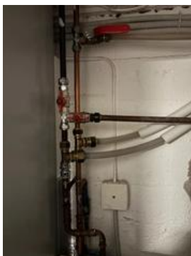
Stoppekran for varmt og kaldt vann er plassert lett tilgjengelige i skap på vaskerom, ved varmtvannsbereder.
