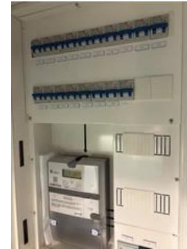
Sikringsskap med automatsikringer plassert i vegg på vaskerom.
