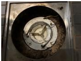
Baderomssluk plassert i dusjsone.
