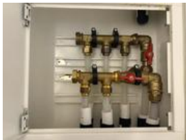
Rørfordelerskap plassert i vegg på badetrom i 1 etg.
