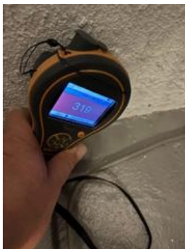
Fuktmålinger på overflater til yttervegg i vaskerom - rom under terreng - viser forhøyde fuktverdier.
