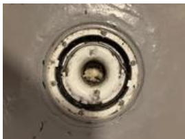
Sluk plassert på gulv ved vaskeum.
