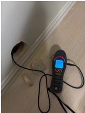
Hulltaking med fuktmåling i utførende yttervegg under terreng (kjellerstue) viser fuktverdier noe over grenseverdier på fukt på 20%.
