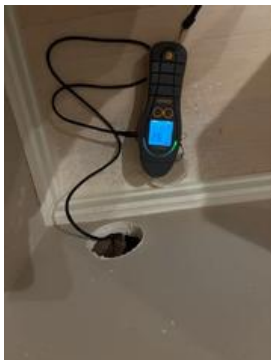
Hulltaking med fuktmåling mot våtsone uten avvik målt fra tiliggende soverom.
