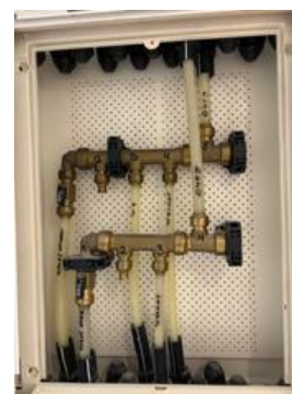
Rørfordelerskap plassert i vegg på baderom i 2 etg.
